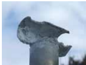
腐食破損したオーニングステー
