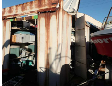
大破した利用者倉庫
