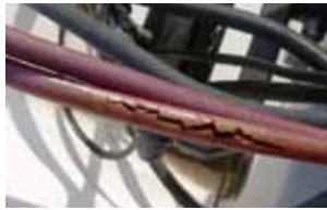
交換が必要な状態です
